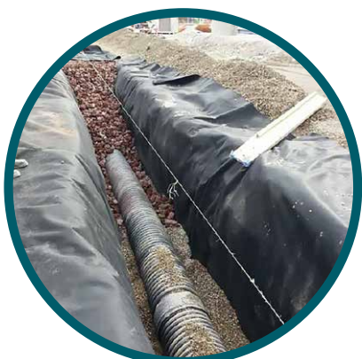
Tranchée drainante cinéma Family • Saint-Just Saint-Rambert
