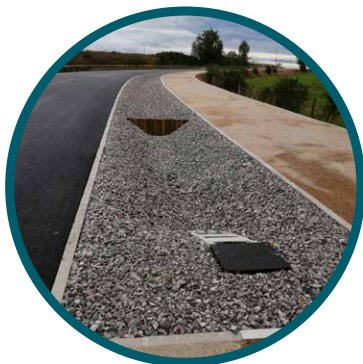
Noue minérale chemin de l'Horre • Sury-le-Comtal
