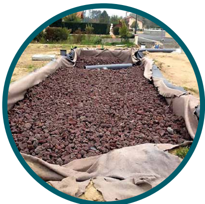
Structure stockante lotissement Les roseaux • Mornand-en-Forez
