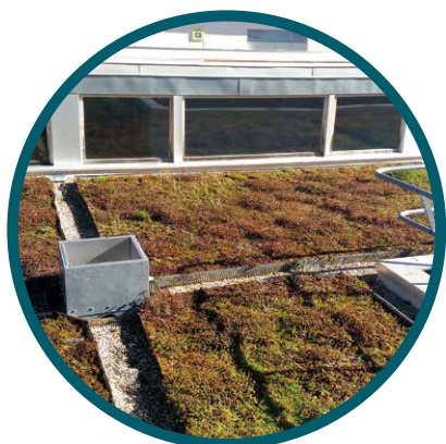
Toitures végétalisées hôtel d'agglomération de Loire Forez • Montbrison
