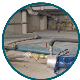
Bâche de récupération Loire Forez agglomération • Montbrison
