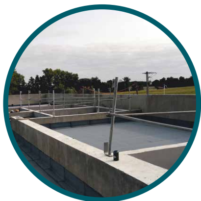
Toitures stockantes station d'épuration • Saint-Marcellin-en-Forez
