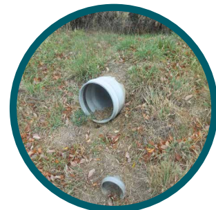
Ajutage cylindrique bassin de rétention aérien Chantepedrix • Essertines-en-Chatelneuf
