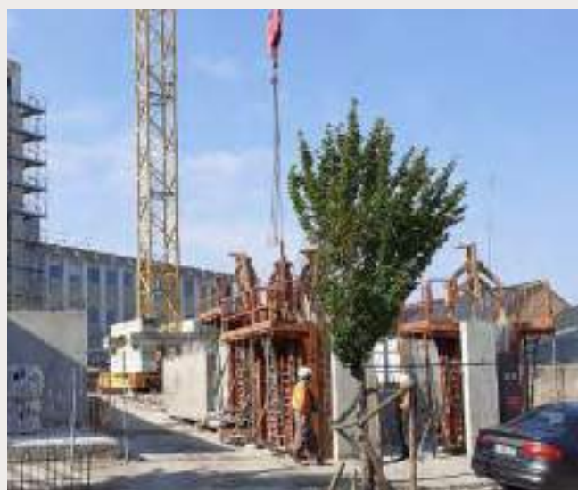
Sur la photo du haut (avant travaux), l'arbre de gauche a été supprimé pour créer l'accès charretier en phase travaux.
