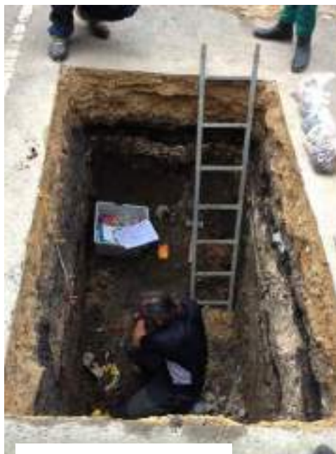
Fosse pédologique pour la caractérisation des sols. Projet Lisière d'une Tierce Forêt (voir p 69), Aubervilliers (93). © Fieldwork architecture, Ekoeco, Ekolog, EcoSustain
